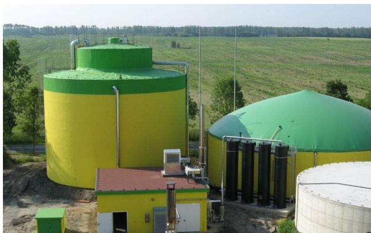
Рис. 3.1. Внешний вид биогазовой станции (здание цилиндрической формы – метантенк шатрового типа – накопитель биогаза).
